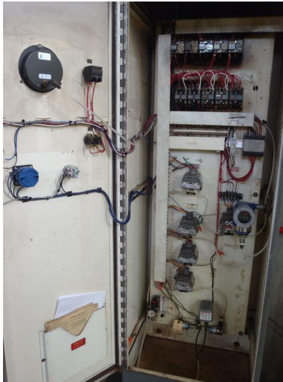
Figure 129-3. Taussig Blvd Bubbler Panel
